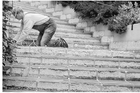
Beispiel einer beheizten Treppe
